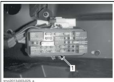
1. Основной блок предохранителей
